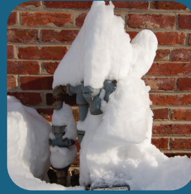
MEDIDOR SIN PROTECCIÓN PARA NIEVE
