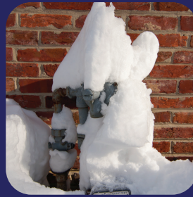
MEDIDOR SIN PROTECCIÓN PARA NIEVE
